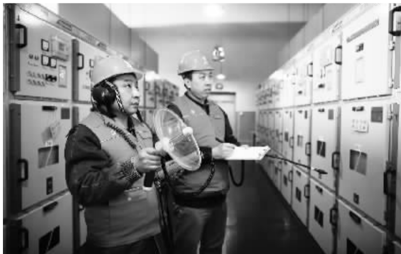
两名用电检查员手举测温仪,在通州站配电室开始工作
